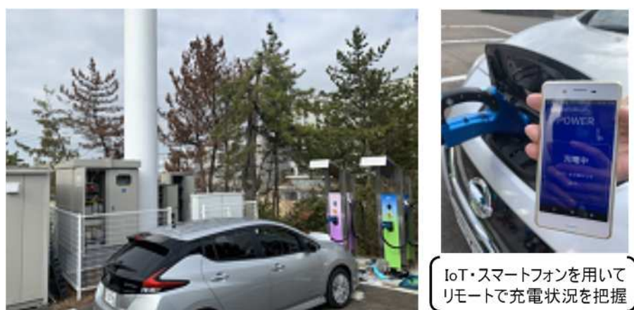
図2 直流EV給電装置
